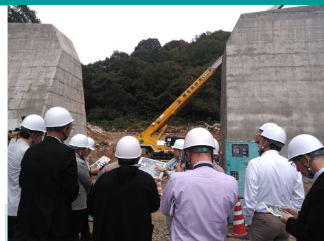
10月30日 党県議団砂防対策委員会視察 平成30年7月豪雨で被害を被った広島県呉市他三か所を回り、復旧現場を視察する。
